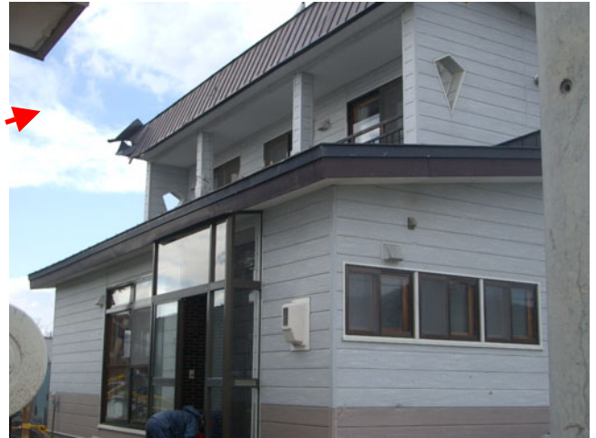
写真 33 屋根が一部損傷した住宅
