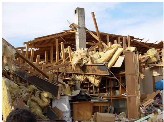
写真 15 事務所併用住宅の被害
