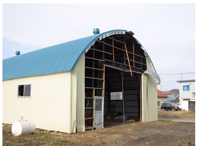
写真 27 外壁が飛ばされた倉庫
