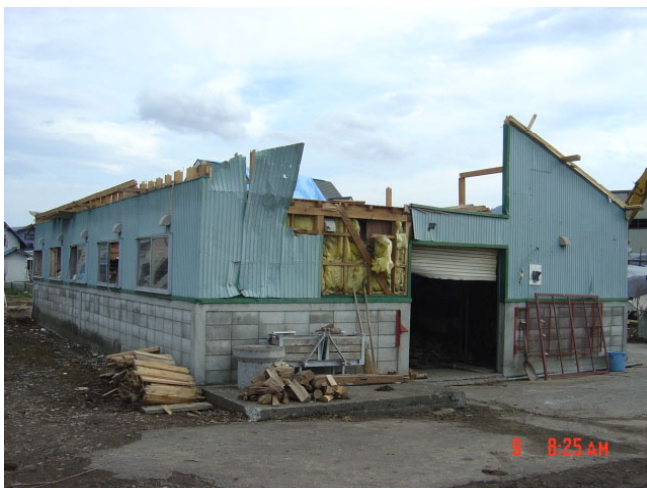
写真 26 屋根が飛ばされた倉庫
