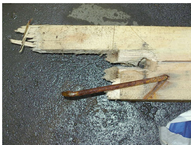
写真9 土台側に残ったかすがい (A棟)
