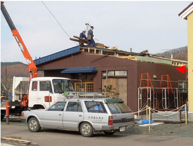
写真 34 屋根（下地材を含む）が飛散した住宅
