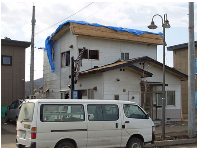
写真 18 屋根葺き材が飛散した住宅
