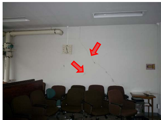
写真 B-11 耐力壁のせん断ひび割れ (1 階、損傷度 III)
