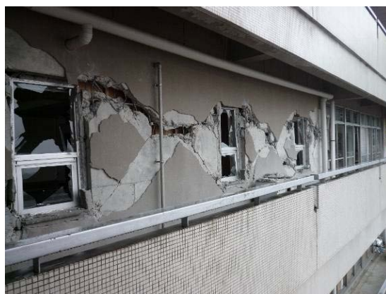
写真B-18 非構造壁のせん断破壊(2階)
