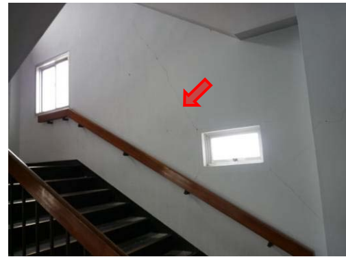
写真 B-36 階段室まわり耐力壁の せん断ひび割れ (2 階)
