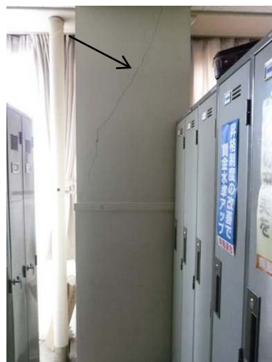
写真 B-22 柱のせん断ひび割れ （3 階、損傷度Ⅲ）
