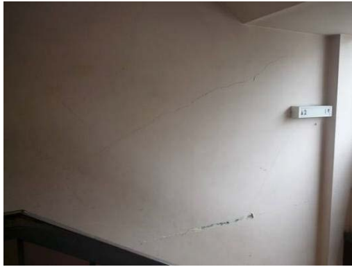
写真 B-23 耐力壁の被害（2 階梁間方向）
