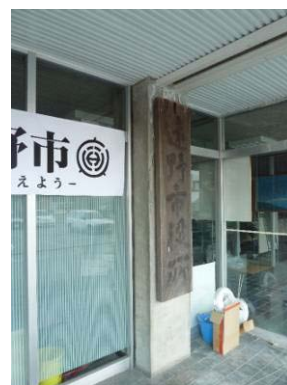
(c) 長柱せん断ひび割れ
