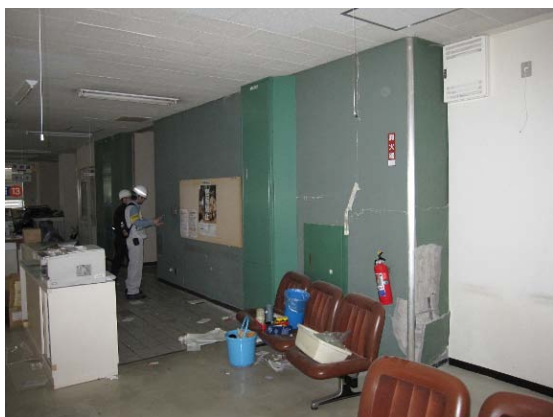
写真B-15 耐力壁側柱の主筋座屈(1階)
