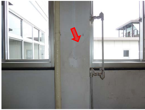
写真 B-33 腰壁、垂れ壁付き柱のせん断ひび割れ (1 階、損傷度 II)
