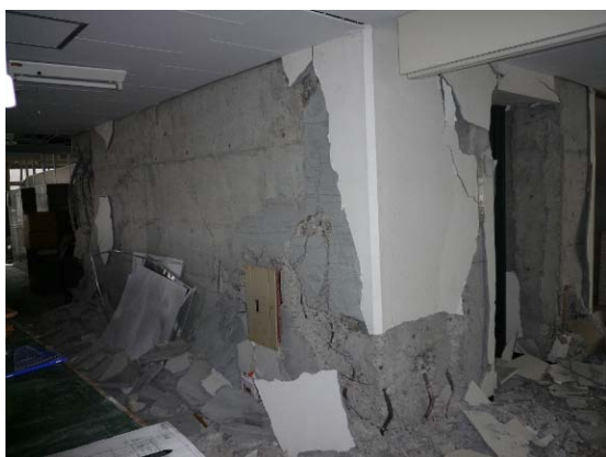
写真B-17 耐力壁のせん断破壊(2階)
