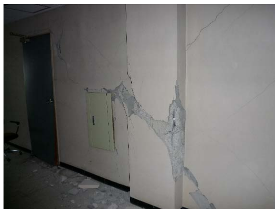
写真B-16 長柱のせん断破壊(2階)
