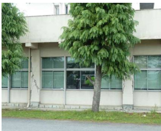
(a) 南側構面柱のせん断破壊
