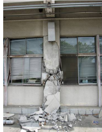
(c) 建築物 I (損傷度 V)
