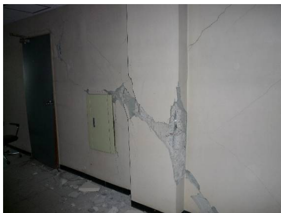
(a) 建築物 C (損傷度 IV)
