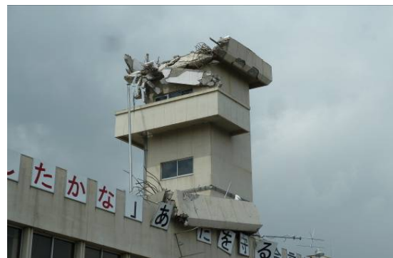
写真 5. 2. 1-4 塔屋の損傷及び落下
