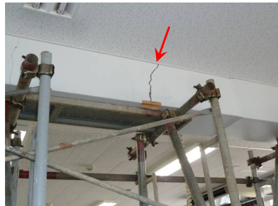
写真 5.2.3.3-6 建物梁間方向の梁中間部に生じたひび割れ（㊟通り：ひび割れ幅 5mm）
