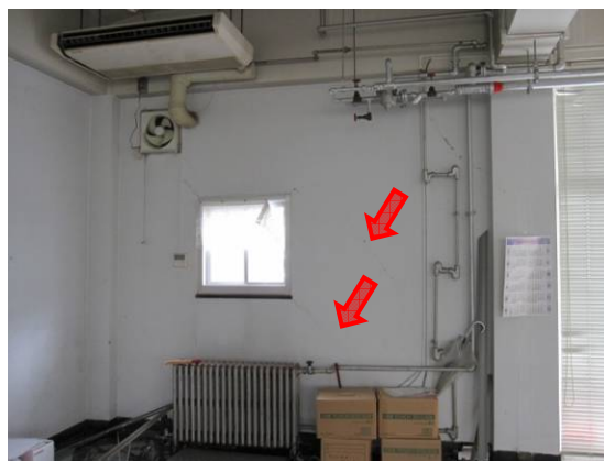
(b) 建築物 G (損傷度 II)
