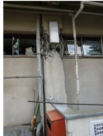
(b) 建築物 I (損傷度 V)
