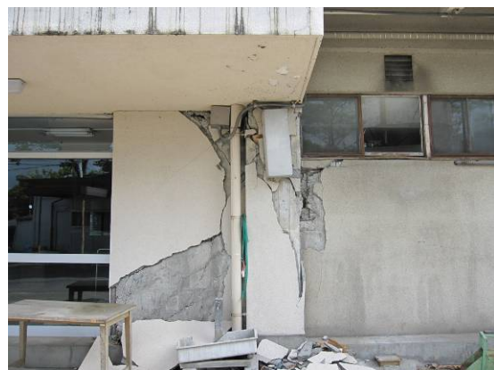
(b) 建築物 I (損傷度 V)
