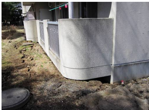
写真 5. 2. 1-3 4 階建て建築物の傾斜
