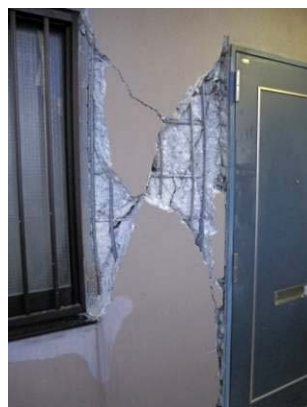
写真 5.2.1-12 非構造壁（玄関側）のせん断破壊
