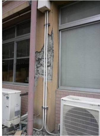
(b) 建築物 F (損傷度 IV)
