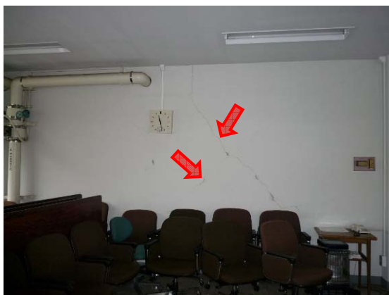
(a) 建築物 B' (損傷度 III)
