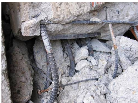
写真 5. 2. 1-7 SRC 造柱脚ベースプレート付近の 主筋座屈
