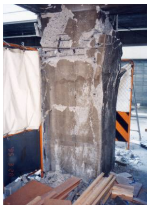
(b) 柱主筋段落とし部の破壊 (表 5.2.1-1 の 4))
