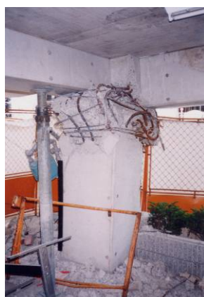
(e) 軸力の大きな柱の破壊 (表 5.2.1-1 の 3))
