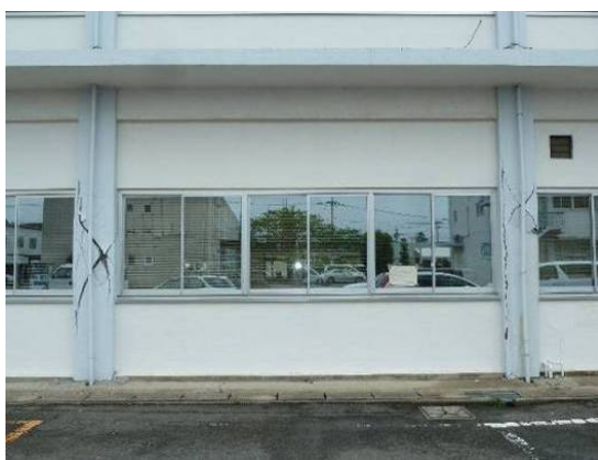
(a) 建築物 H (損傷度 IV)
