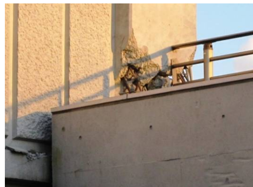
写真 5. 2. 1-6 連層耐力壁側柱脚部の圧壊
