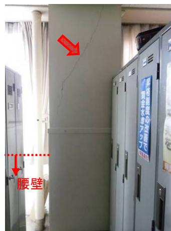
(b) 建築物 E（損傷度 III）
