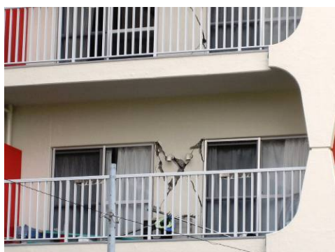
写真 5.2.1-13 非構造壁（ベランダ側）のせん断破壊
