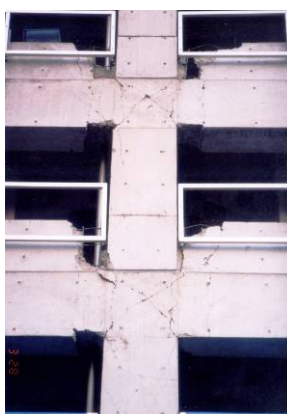
(d) 柱はり接合部の破壊 (表 5.2.1-1 の 10))
