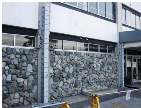
写真 5. 2. 1-10 応急補強した柱の被害
