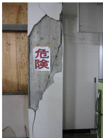
(a) 建築物 B（損傷度 III）
