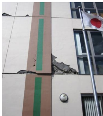
写真 5.2.1-11 袖壁脚部の損傷
