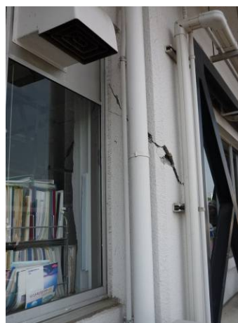
(b) 建築物 J (損傷度 IV)
