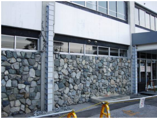
(a) 建築物 A (損傷度 V)
