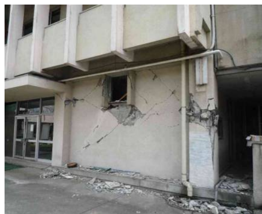
(b) 有開口耐力壁のせん断破壊
