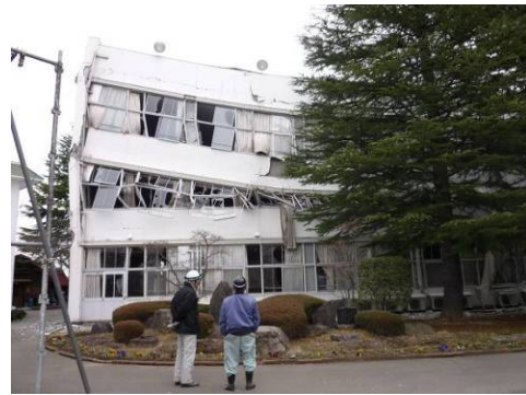
写真 5. 2. 1-2 中間階の層崩壊
