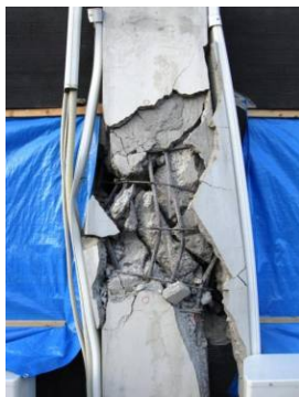
(a) 短柱のせん断破壊
