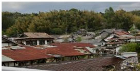
写真 5.6.2 屋根の被害が多い益城町小谷
