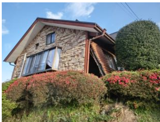
写真 5.2.14 壁が外れた建築物
