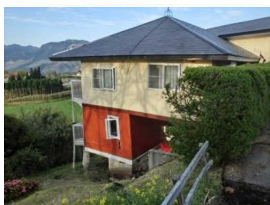
写真 5.2.16 1 階の RC 支柱が傾斜した建築 物
