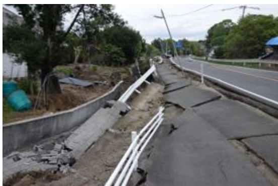
写真 5.7.3 破壊された路盤
