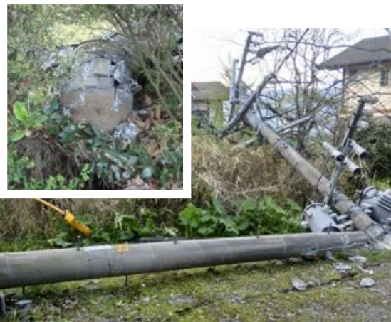
写真 5.2.6 エリア内の電柱の折損
