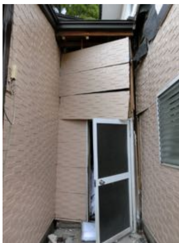
写真 5.1.8 食堂棟と宿泊棟の接続部の破壊
