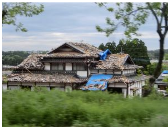
写真 5.5.1 屋根の被害が大きな入母屋
