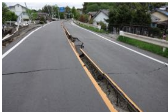
写真 5.7.4 アスファルト舗装に生じた割れ
