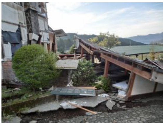
写真 5.2.13 下屋が崩壊した建築物
