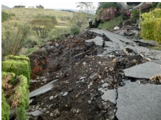
写真 5.2.1 アクセス道路の路盤崩壊
