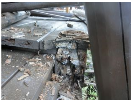
写真 5.1.18 写真 5.1.16 の独立柱脚部の腐朽
