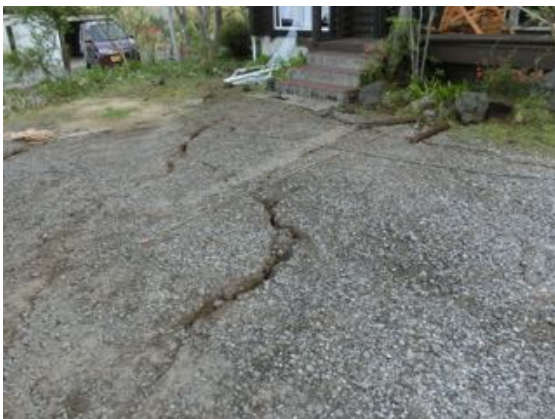
写真 5.1.15 ログハウスの南側地盤の亀裂
