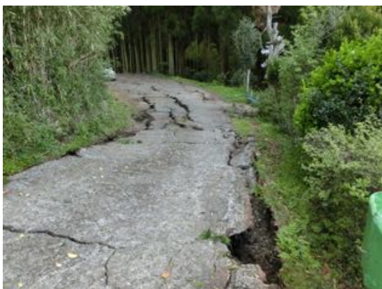
写真 5.2.4 エリア内の道路の亀裂
