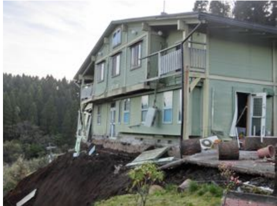
写真 5.2.8 敷地の西側が抉り取られた建築物
