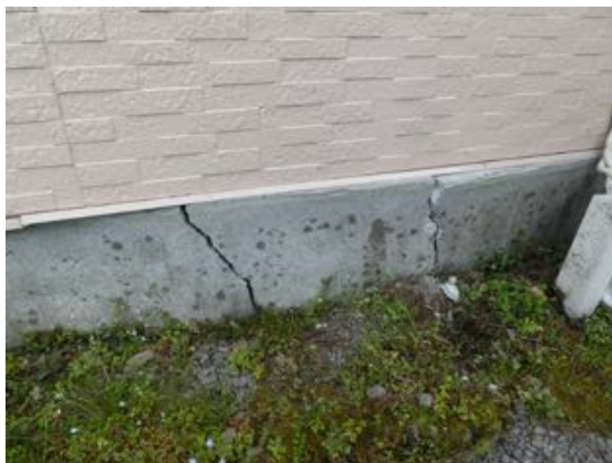
写真 5.1.6 宿泊棟の基礎の亀裂
