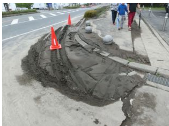
写真 5.7.6 液状化により噴出した大量の砂
