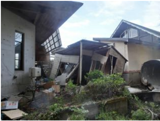
写真 5.1.13 食堂棟東側の付属屋の大破
