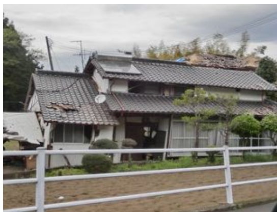
写真 5.5.2 残留変形が大きな民家
