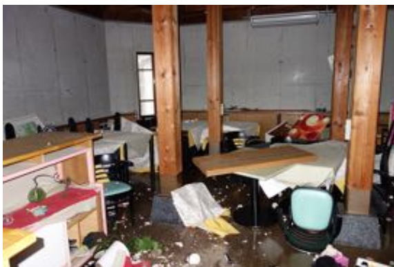
写真 5.1.4 RC 造食堂棟の内部の被害状況
