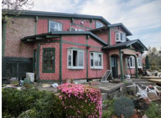
写真 5.2.10 崖下へ傾斜した木造宿泊施設
