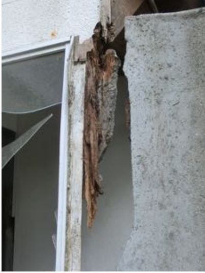
写真 5.1.11 写真 5.1.10 の木部の腐朽
