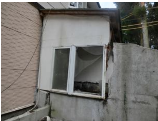
写真 5.1.10 宿泊棟北側の浴室の破壊
