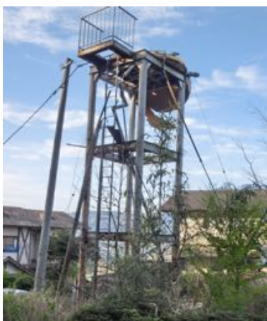
写真 5.2.5 給水タンクの落下
