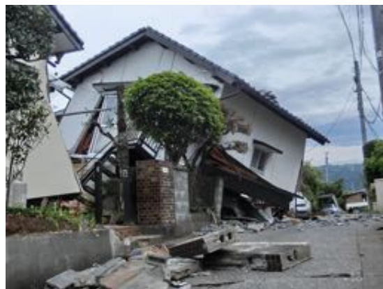
写真 5.7.10 木山地区の倒壊家屋
