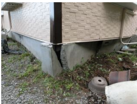
写真 5.1.7 宿泊棟の基礎の破壊
