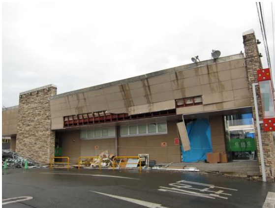
写真 4. 2. 2. 13 乾式工法による外壁材の損傷・傾斜
