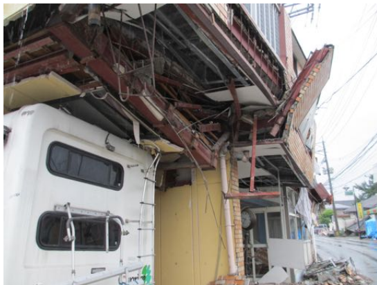
写真 4.2.1.20 崩壊した 2 層部分
