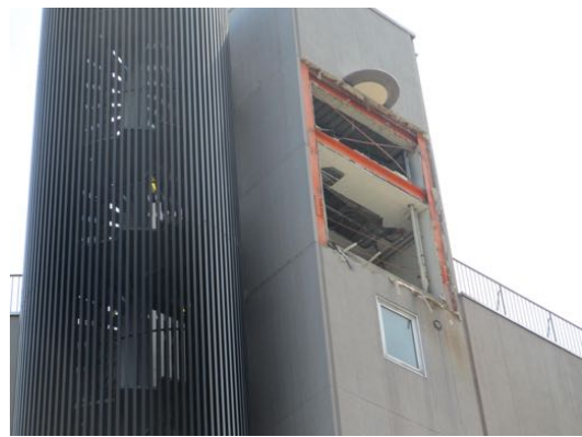
写真 4. 2. 1. 9 塔屋の外装材の脱落
