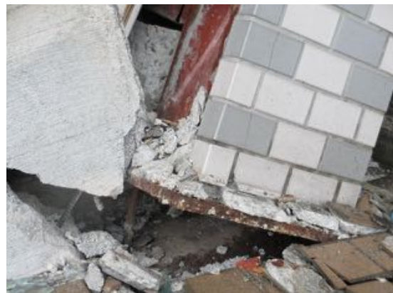
写真 4. 2. 1. 17 柱脚部の損傷状況
