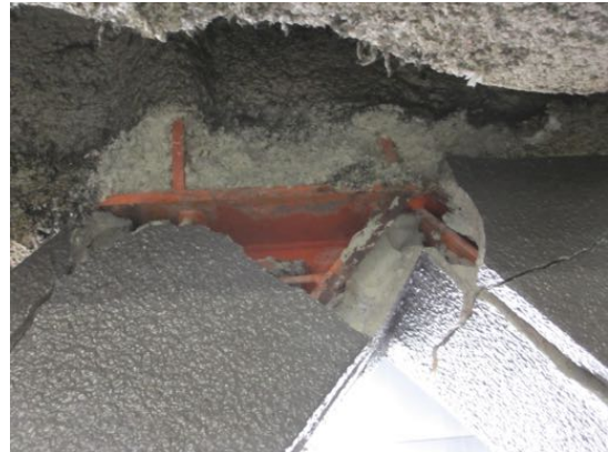
写真 4. 2. 1. 11 ブレース交差部の耐火被覆の剥離
