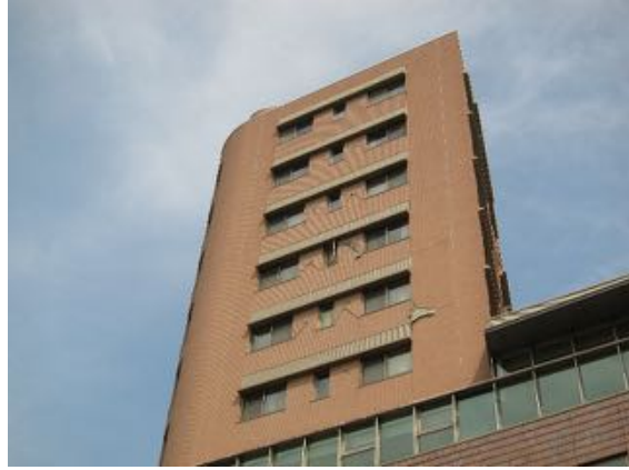
写真 4.2.2.16 外壁タイルの脱落
