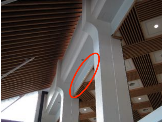
写真 4. 2. 2. 5 立ち上がり壁の脱落箇所
