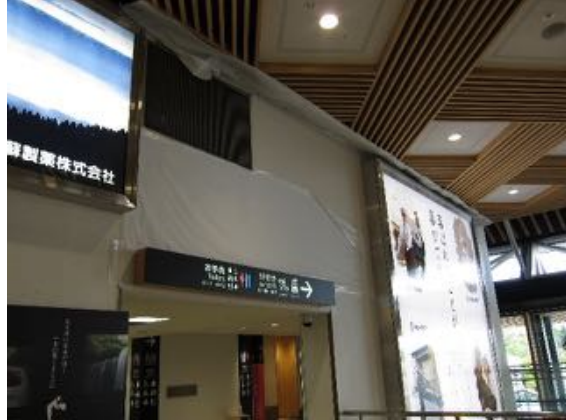
写真 4. 2. 2. 6 天井と壁の取合い部分での損傷
