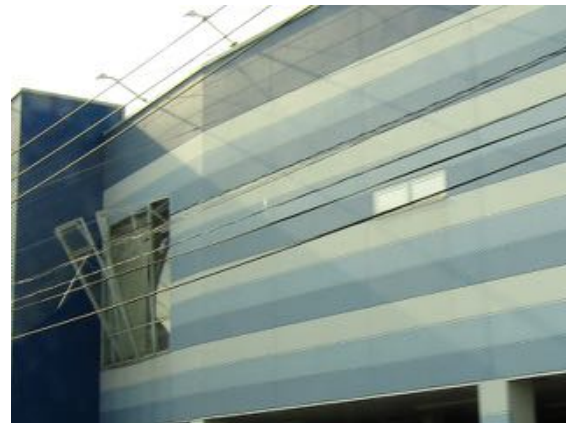
写真 4.2.2.18 窓サッシの損傷・外れ
