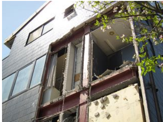
写真 4. 2. 2. 14 乾式工法による外壁材の脱落
