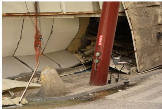
写真 4. 2. 3. 3 連結送水管送水口の付近の破損
