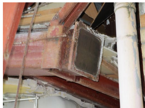
写真 4.2.1.23 柱梁接合部のパネル溶接部の破断
