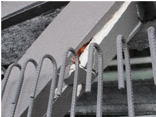
写真 4. 2. 1. 10 ブレース端部の耐火被覆の亀裂
