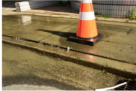
写真 4. 2. 3. 2 被害建築物付近での漏水
