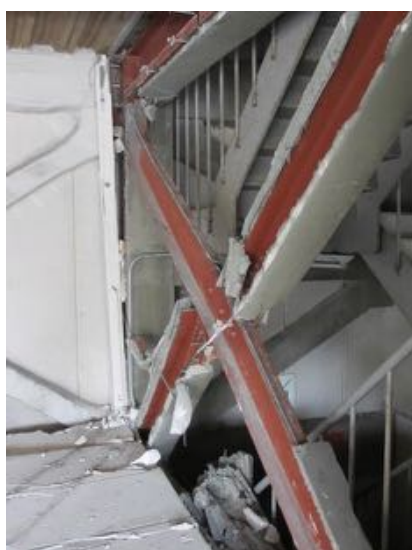
写真 4. 2. 1. 5 溝形鋼ブレースの座屈
