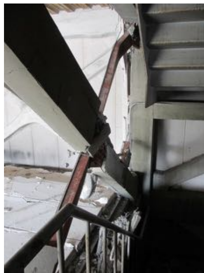
写真 4. 2. 1. 4 ブレースの耐火被覆の剥落
