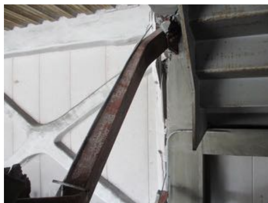
写真 4. 2. 1. 6 溝形鋼ブレース端部の座屈
