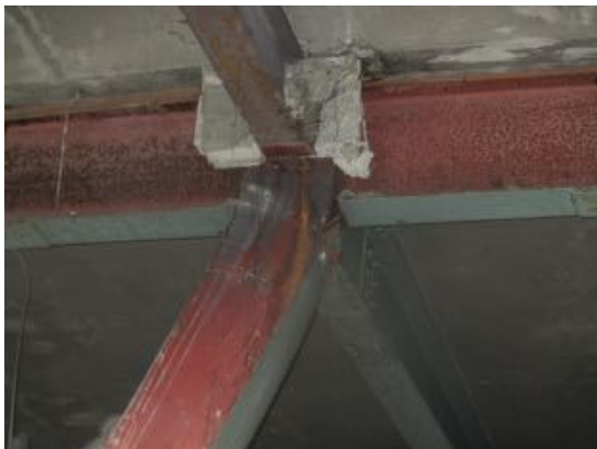
写真 4. 2. 1. 31 1階柱頭部の破壊
