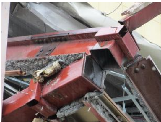
写真 4.2.1.22 柱梁接合部のパネル溶接部の破断
