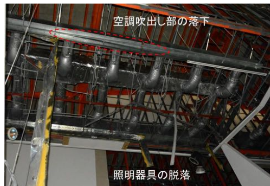
写真 4. 2. 3. 5 照明器具・空調吹出し部の脱落
