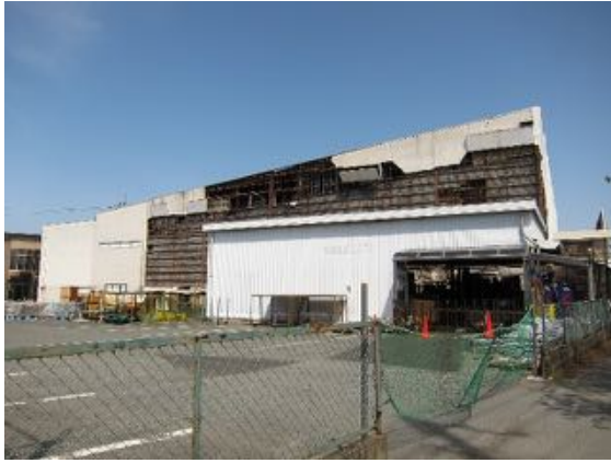
写真 4.2.2.15 湿式工法による壁の脱落
