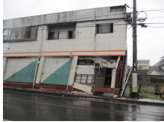
写真4.2.1.25 1層の大きな傾き（南面）
