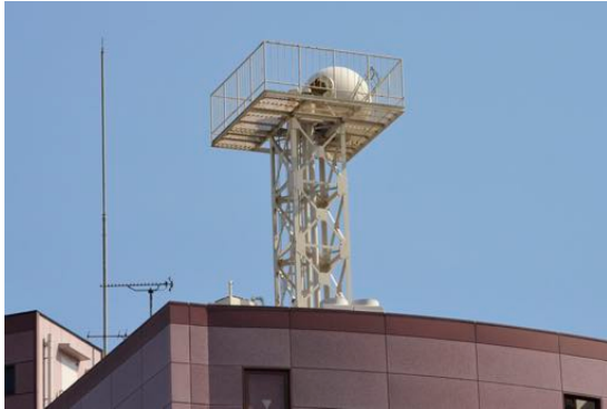
写真 4. 2. 3. 1 屋上設置の高置水槽の転倒
