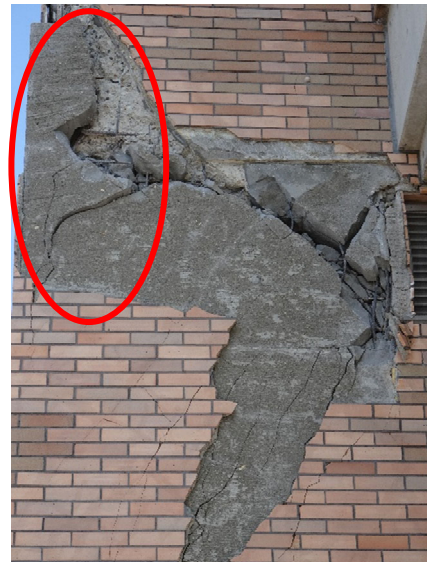
(b) 壁の損傷
