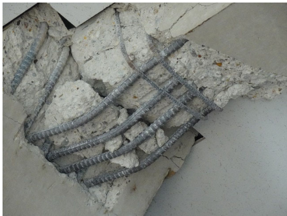
(b) 3 階梁端部の損傷
