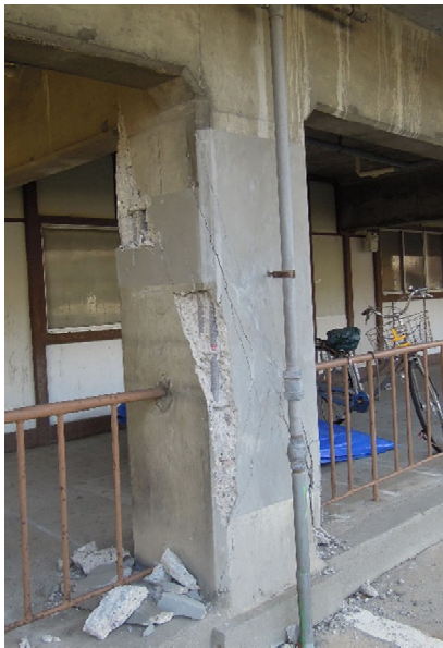
(a) ピロティ柱のせん断破壊
