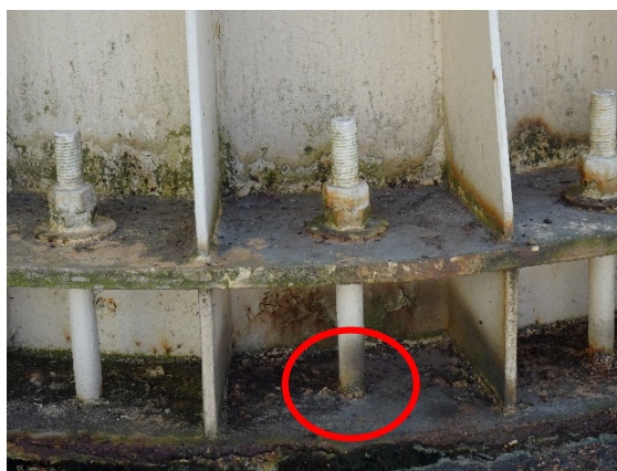
(d) 鋼製煙突の下部の拡大
