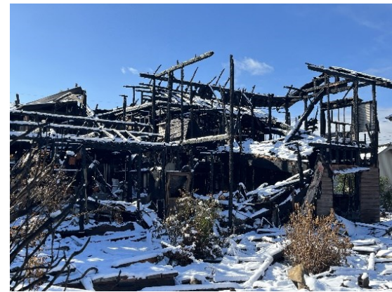
図 6.3.16 火災被害状況(2)
