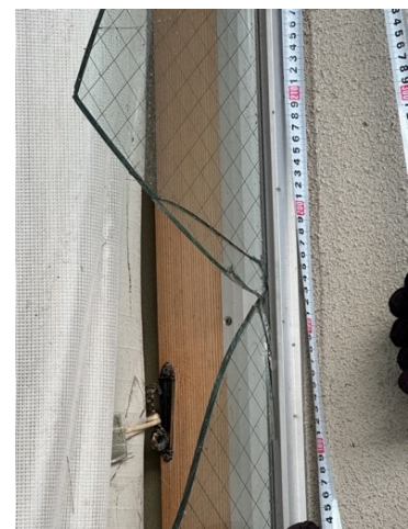
図 6.1.6 損傷した窓ガラスの高さ
