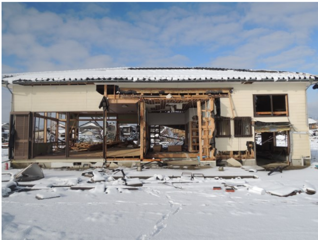
図 6.2.8 津波による前面の被害
