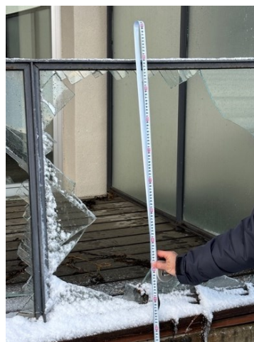
図 6.1.5 損傷したガラスの高さ
