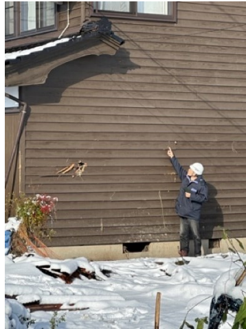
図 6.2.11 津波の漂流物の痕跡
