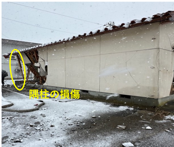
図 5.3.4 津波の正圧による損傷
