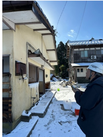
図 6.3.13 外壁の損傷と 津波の痕跡の測量
