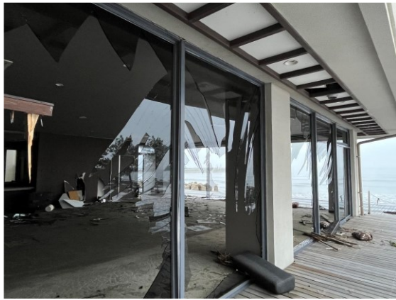
図 5.1.3 1 階の窓ガラスの損傷(2)
