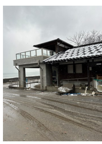
図 5.5.6 RC 造の建築物の 被害状況(2)
