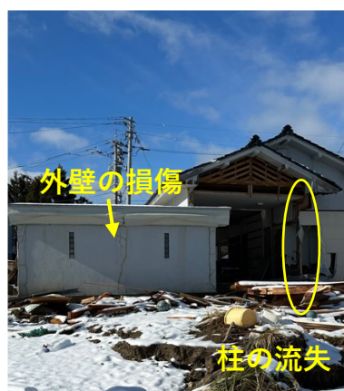
図 6.3.6 外壁の損傷と隅柱の流失
