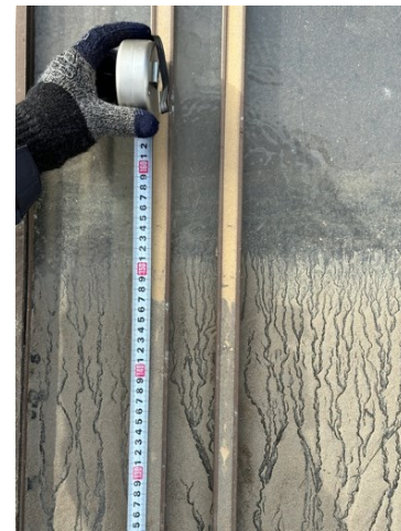
図 6.2.14 玄関に付着した痕跡
