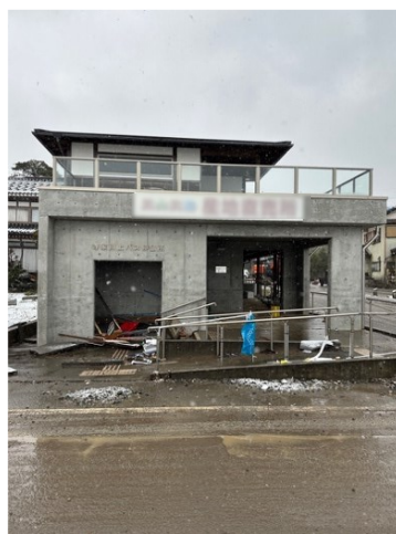
図 5.5.5 RC 造の建築物の 被害状況(1)
