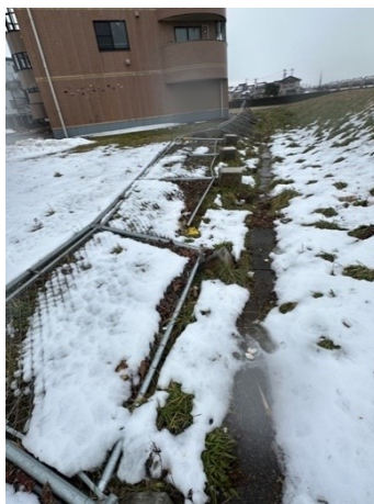
図 4.1.2 フェンスの倒壊
