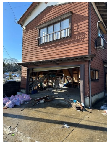
図 6.3.3 津波による開口部の損傷
