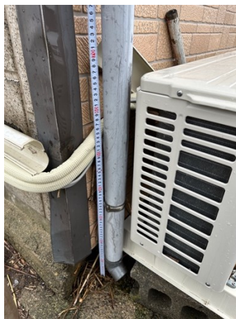
図 4.1.5 津波の痕跡高さ
