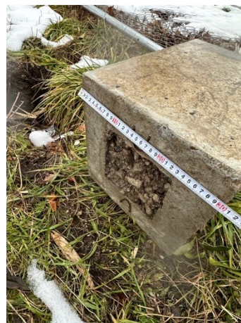
図 4.1.3 フェンスの引き抜けた基礎
