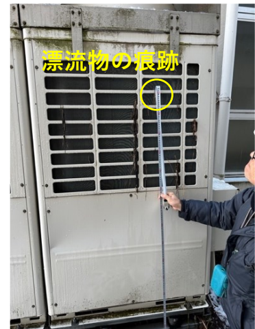
図 6.1.3 室外機に付着した漂流物の痕跡
