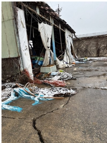
図 5.2.1 鉄骨造倉庫の被害
