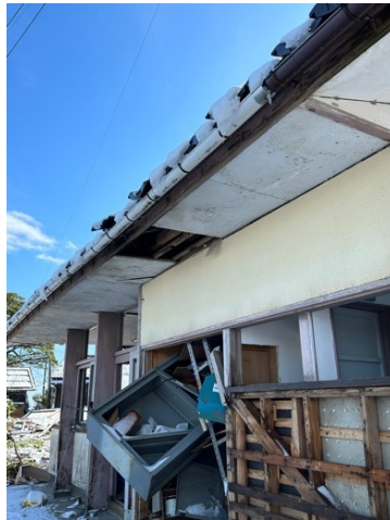
図 6.3.12 軒天井の損傷
