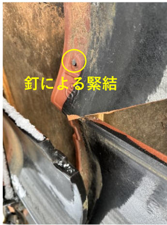
図 6.2.18 瓦の緊結状況
