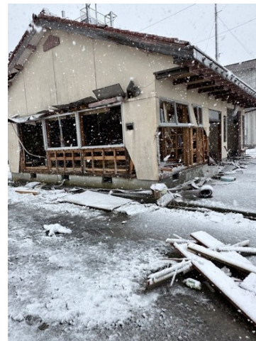
図 5.3.5 側面及び陸側の壁の損傷
