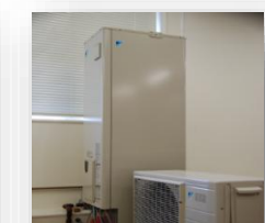
ヒートポンプ 給湯機
